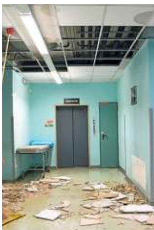
Il crollo dei controsoffitti
